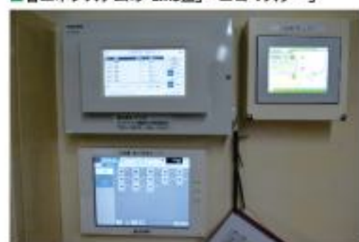
■省エネシステムの「EMS表示・設定盤」・「ショーケースシステム盤」・「空調システム盤」
